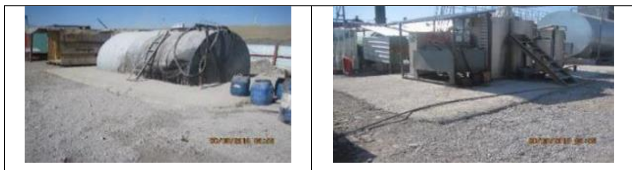
Рисунок 37 Непроницаемое защитное покрытие вокруг емкостей с химическими растворами.
