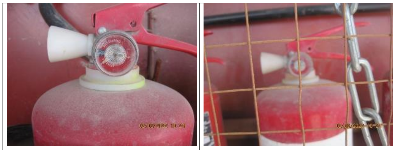
Рисунок 47 Огнетушители, установленные с нарушениями на территории промплощадки.
