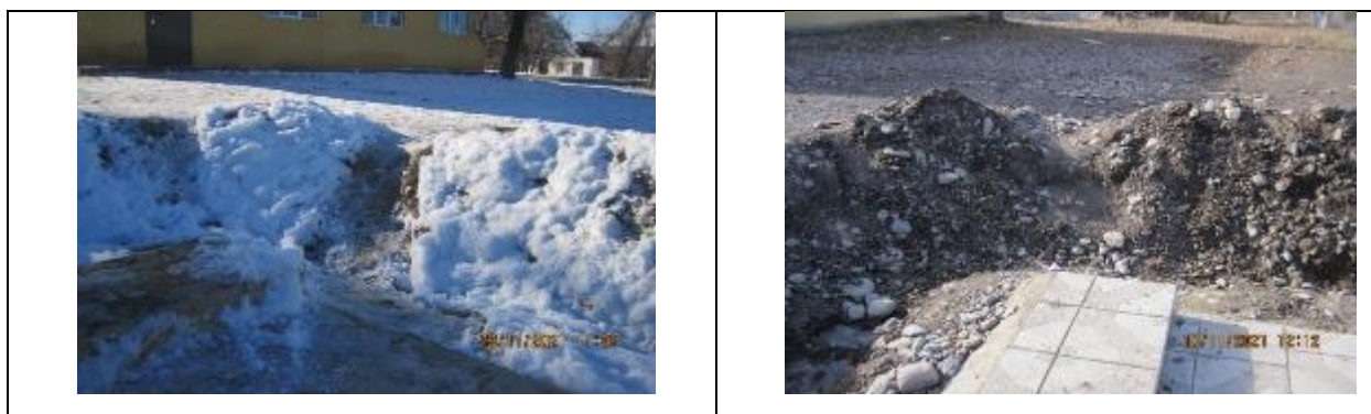
Рисунок 32 Строительные отходы возле подземного перехода у школы в с. Новониколаевка.
